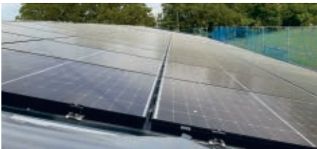
PV Module auf beiden Pultdächern
